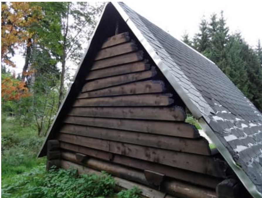
Beim Brand im Jahre 2005 wurde lediglich die Rückseite der Hütte beschädigt
